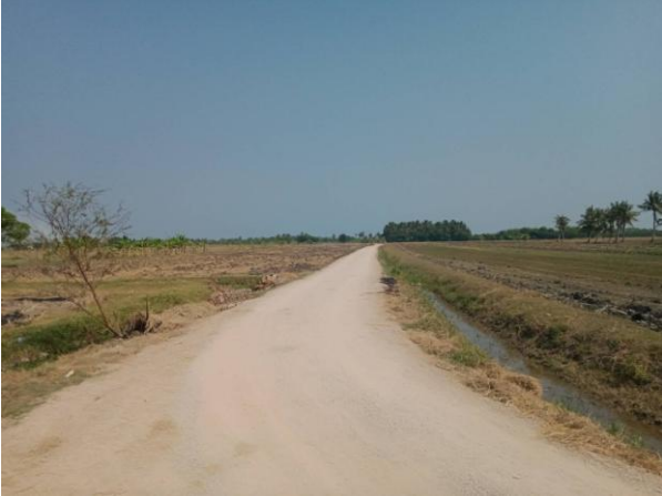
ก่อสร้างถนนหินคลุกบดอัดแน่น จากบ้านนายสมเกียรติ เชื่อมสถานีรถไฟ หมู่ ๖ ตำบลบางเค็ม
